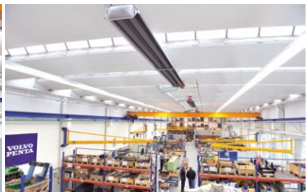
Beheizung einer Fertigungshalle mit Dunkelstrahlern
