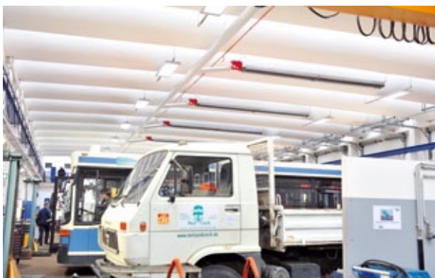
Schwank Dunkelstrahler mit Anbindung an eine isolierte Sammelabgasanlage
