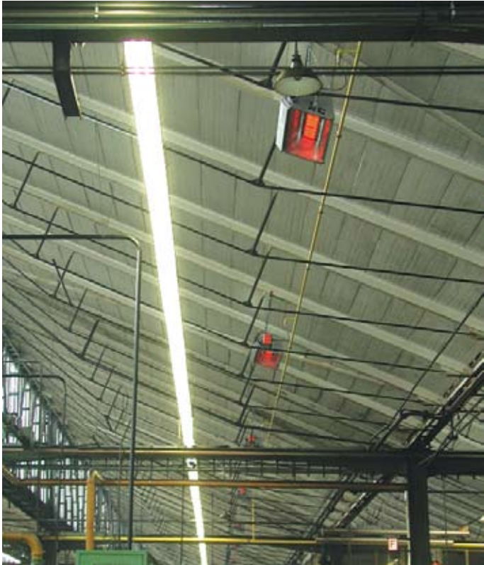
Bild 3: Typische Anordnung von Hellstrahlern unter einem Sheddach
